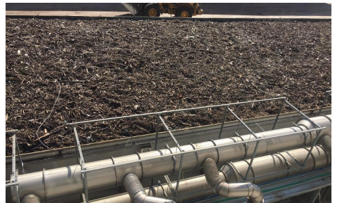
3. BIOFILTRO PER DEPURARE L'ARIA DI PROCESSO
