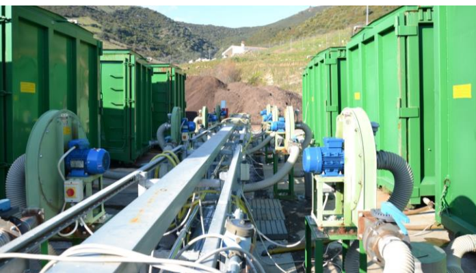
1. SISTEMA AUTOMATICO DI VENTILAZIONE
