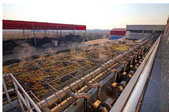
(3) BIOFILTRO® PER ABBATTERE GLI ODORI DEL PROCESSO
