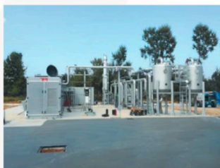
L'upgrade dell'impianto per la produzione di biogas
