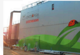
La sezione di digestione anaerobica semi dry Zenviro Tech
